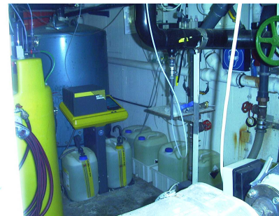
Lagerung von Gefahrstoffen
