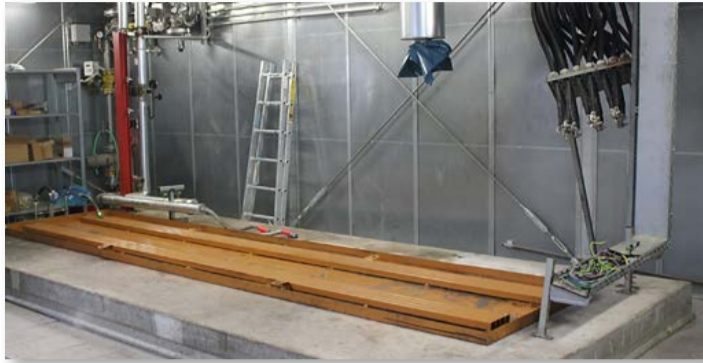
Energiezentrale des Klinikums: Der leere Generatorraum im BHKW.
