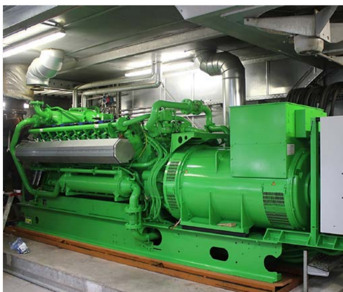
Das Aggregat steht wieder an seinem Platz.
